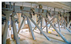
Verteileranlage auf dem Dachboden des Getreidesilos.
